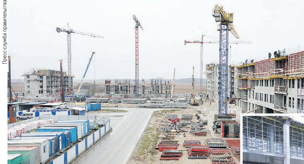
На «восточной площадке» строят учебные корпуса Московской государственной академии хореографии и Центральной музыкальной школы с концертными залами и интернатами.
