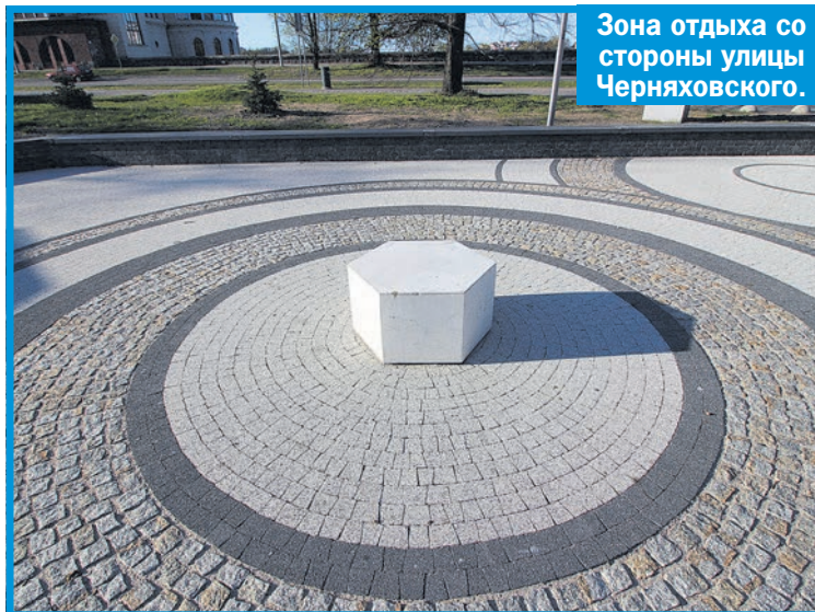
Склон у причала не укреплен, а бетонная лестница вся в ямах.
